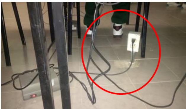
Figura 21 Nótese la mala instalación Eléctrica, con los contactos salidos
