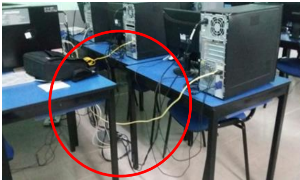
Figura 20 Nótese los cables mal puestos
