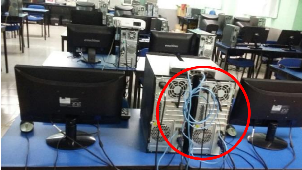
Figura 19 Cableado Lab. de Cómputo mal instalado
